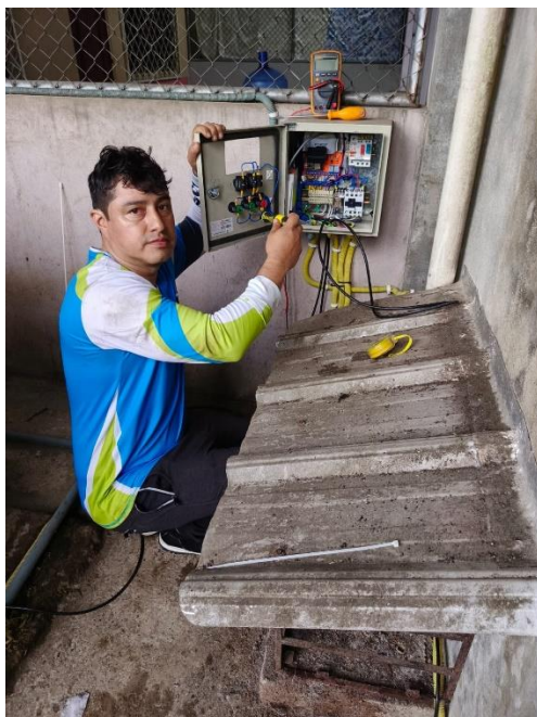
Instalación de elementos en gabinete de control
