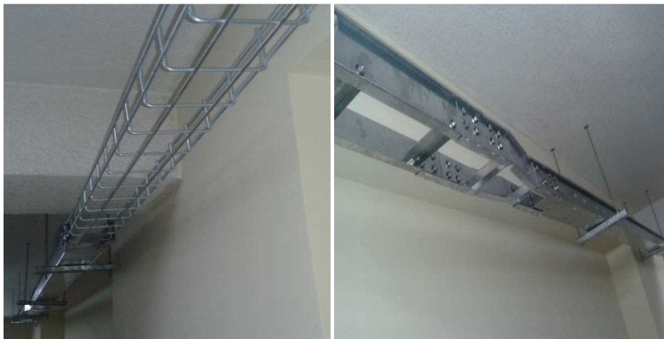
Figura 3.18 Bandejas porta-cables Fuente: El autor
