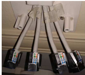
Figura 3.30 Jacks Cat. 6a terminados Fuente: El autor
