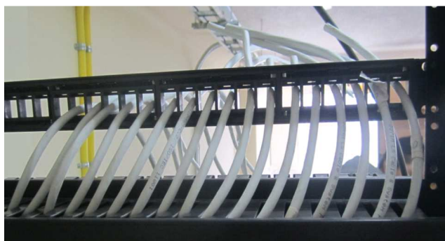
Figura 3.32 Cables de conexión al patch panel Fuente: El autor
