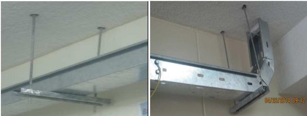
Figura 3.17 Sujeción de bandejas metálicas Fuente: El autor
