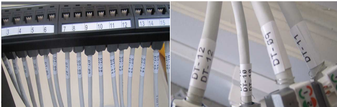
Figura 3.40 Etiquetado cables de red Fuente: El autor
