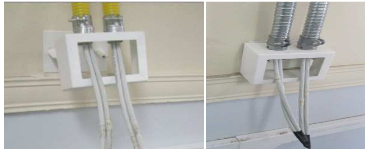
Figura 3.26 Cables de red listos para el ponchado Fuente: El autor
