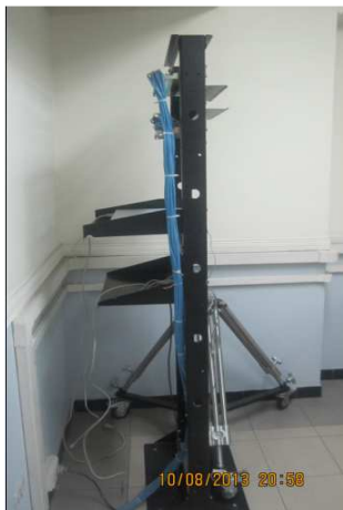
Figura 3.7 Estado inicial de Rack Principal Fuente: El autor
