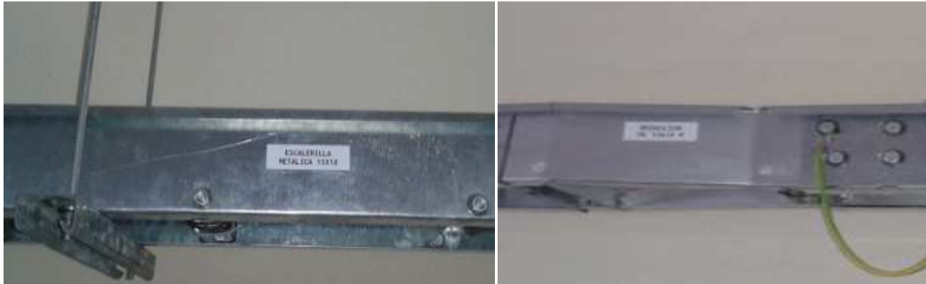
Figura 3.39 Etiquetado de bandeja porta-cables Fuente: El autor
