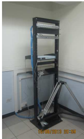
Figura 3.3 Rack principal (estado inicial) Fuente: El autor
