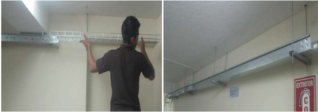
Figura 3.16 Sujeción de bandejas metálicas Fuente: El autor
