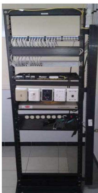
Figura 3.36 Rack principal terminado y etiquetado Fuente: El autor
