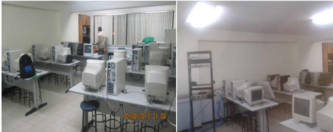
Figura 3.2 Inspección al área asignada para la nueva red de comunicaciones Fuente: El autor
