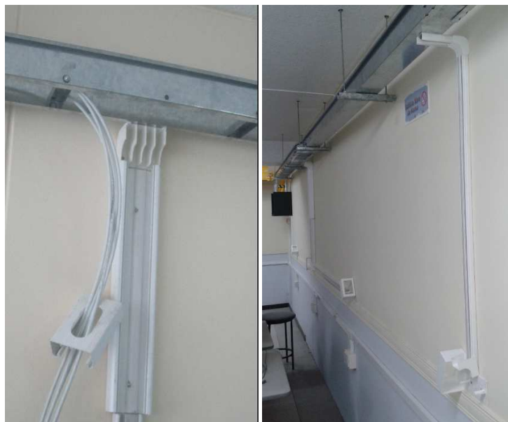
Figura 3.20 Ductos decorativos para bajantes terminales Fuente: El autor
