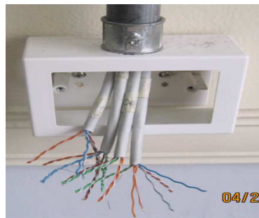
Figura 3.27 Cable sin chaqueta Fuente: El autor
