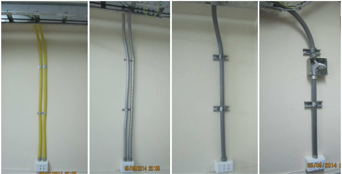
Figura 3.19 Ductos industriales para bajantes terminales Fuente: El autor
