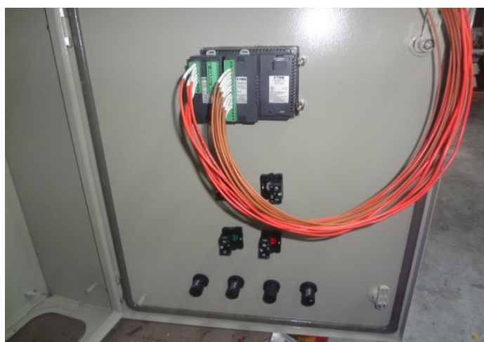
Figura 3.38 Conexionado desde módulos de expansión a borneras (Fuente: Autor)
